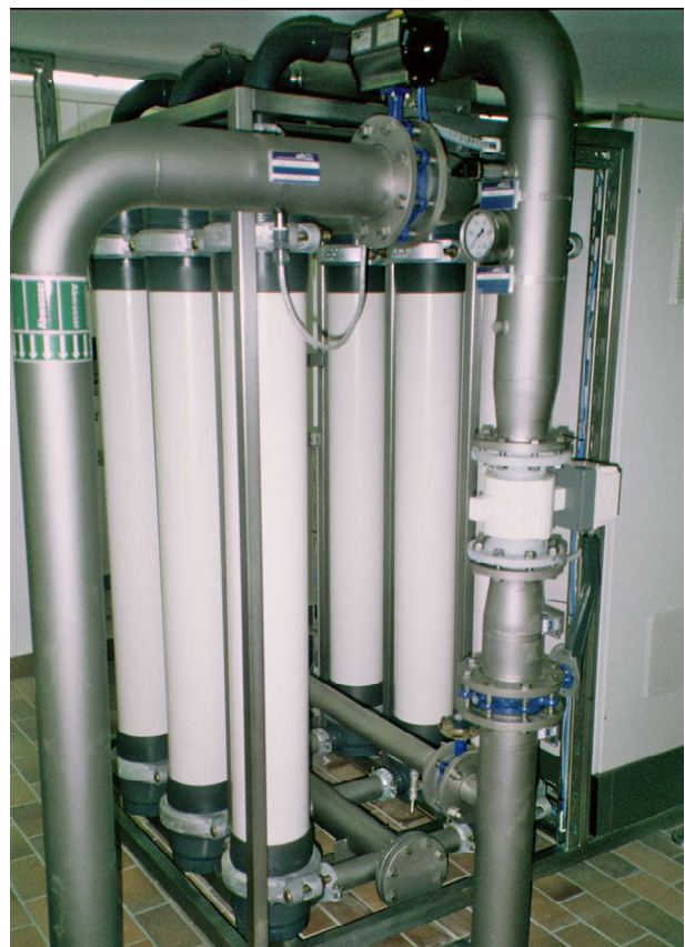
Abb. 2: Ultrafiltrationsanlage zur Trinkwasseraufbereitung
