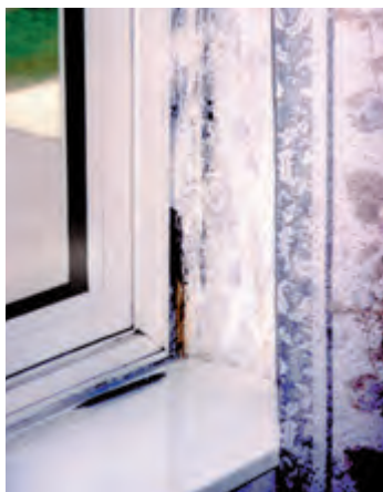
Schimmelpilzbefall in der Fensterlaibung
