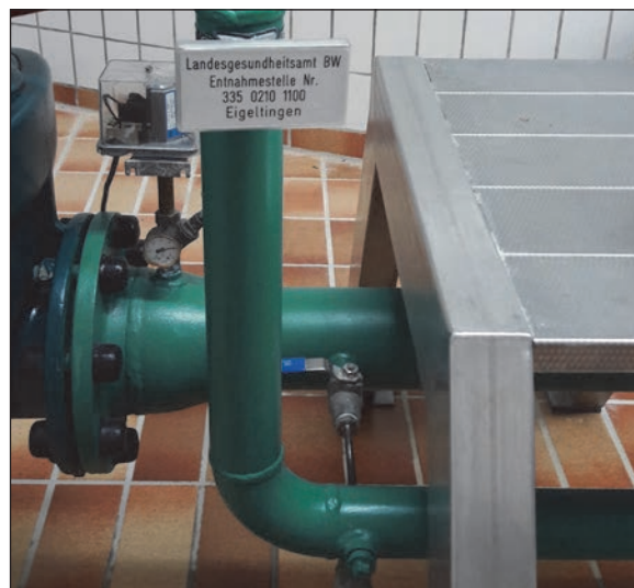
Entnahmestelle Trinkwasser (Quelle: LGA)
