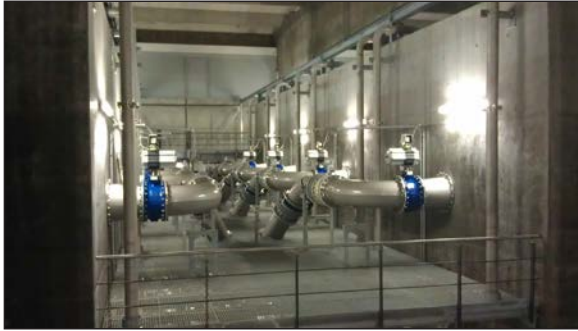
Filterabläufe im Wasserwerk. Quelle: LGA
