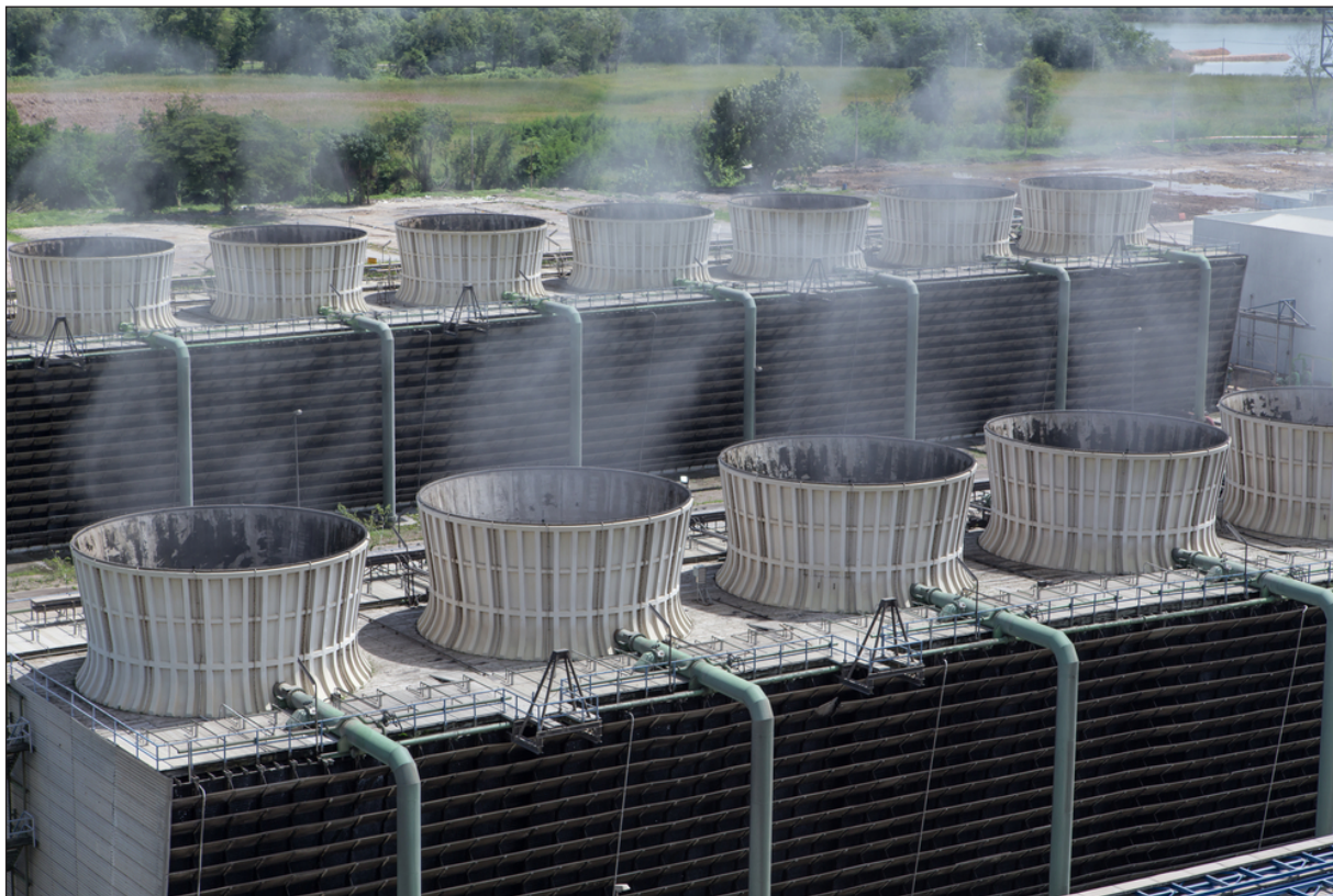
Verdunstungskühlanlage (Quelle: https://www.technikplushygiene.info )
